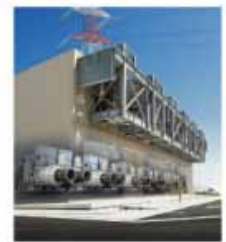
ガスタービン発電機
